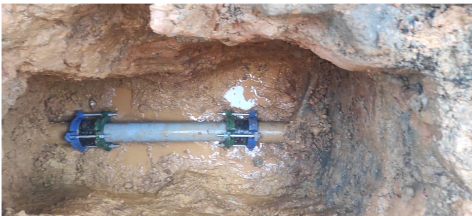
Reparación en tres tramos de la tubería de distribución en el Barrio Pichincha
